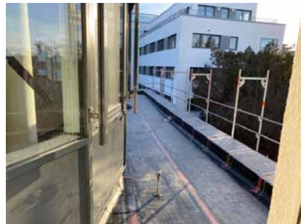
Auf dem Dach des Erdgeschosses entsteht im hinteren Bereich ein begrüntes Dach. Die erste Schicht an Planen ist verlegt.
