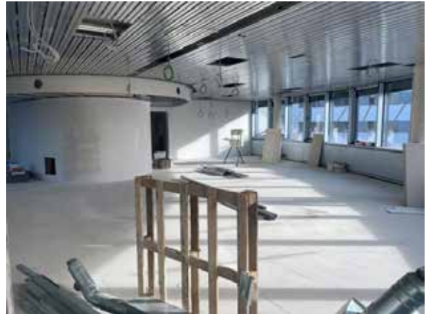
Und jetzt ist alles verkleidet. Inzwischen ist auch die Heiz- und Kühldecke eingebaut. Das Büro nimmt Form an.
