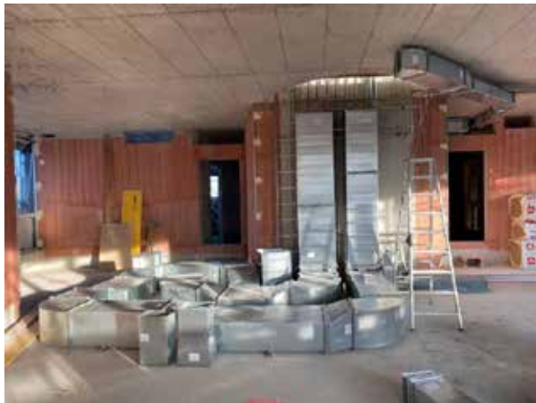
Ein Teil der Lüftungskanäle läuft hier unter dem doppelten Boden. Hoffentlich kennen sich die Monteure mit diesem Wirrwarr von Kanälen aus!
