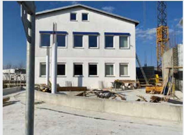
Und jetzt sind wir im 1. Stock. Im Bereich außerhalb des inneren Sockels wird eine begrünte Dachfläche entstehen. Ein schöner Ausblick für Alle im zukünftigen Verkaufsbüro.
