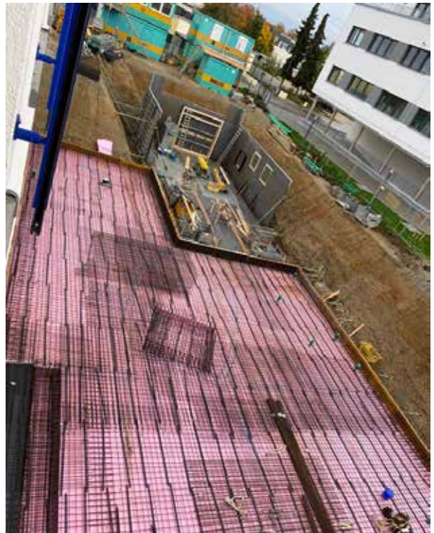
Die Stahlflechter sind kräftig am Arbeiten und im vorderen Bereich werden die Verschalungen für die ersten Kellerwände aufgebaut.
