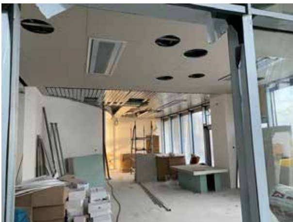
Im Eingangsbereich fehlt die endgültige Decke noch im hinteren Bereich. Dort muss noch der Feuerschutzvorhang vor dem Treppenhaus installiert werden.
