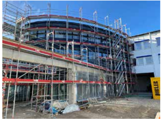
Blick auf den großzügigen Eingangsbereich. Noch ist er durch Gerüste verbaut. Der Platz vor dem Eingang erhält ein großes Glasdach, so dass bei DICTATOR niemand im Regen steht
