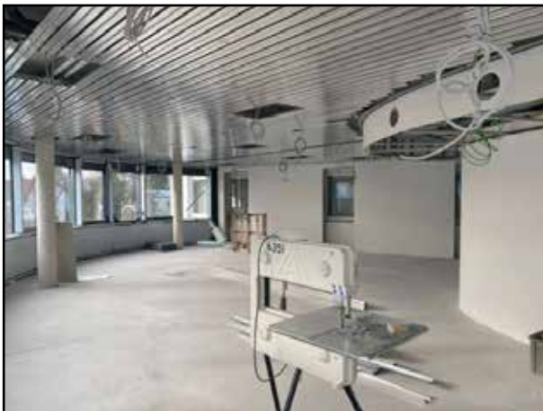
Dort wo hinten noch Fenster zu sehen sind, wird der Neubau mit dem Altbau durch Türen verbunden.
