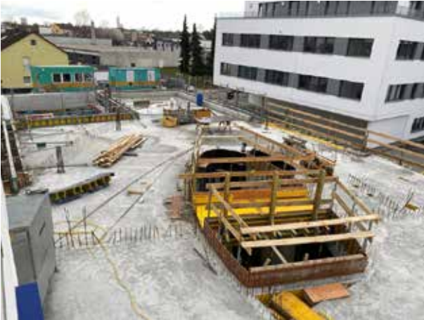
Und schon wird wieder an der Verschalung der Treppenhaus-Ellipse gearbeitet . Als erstes entsteht die "Brücke".
