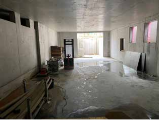
Dieser Keller wurde ausschließlich für die Lüftungsanlage gebaut. Das neue Gebäude soll nicht durch Unmengen von Technik auf dem Dach verschandelt werden.
