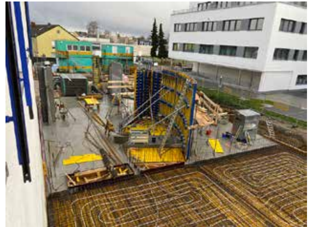
Endlich sind die Heizschleifen verlegt. Im vorderen Bereich wird kräftig an der Verschalung des Treppenhauses gearbeitet.
