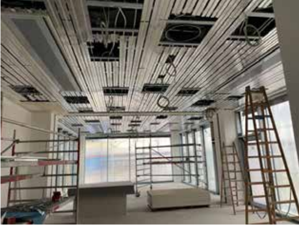
Die Heiz- und Kühldecke sowie die Lüftungsgeräte sind im Multifunktionsraum eingebaut.
