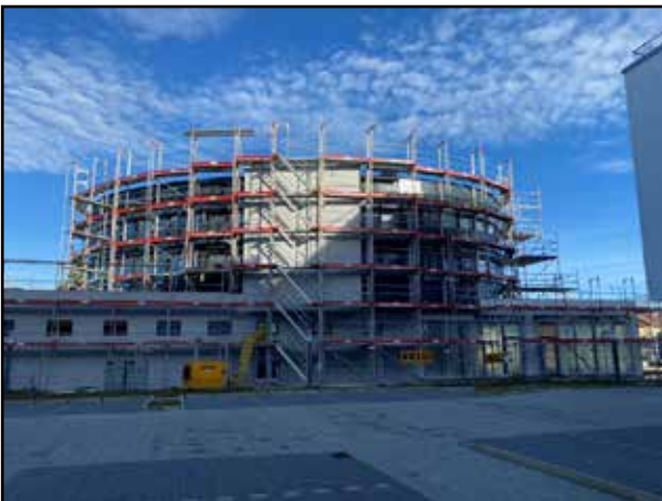
Ein Blick auf den Anbau vom Nachbargrundstück aus. Wie es wohl aussieht, wenn das Gerüst nach der Winterpause abgebaut wird?
