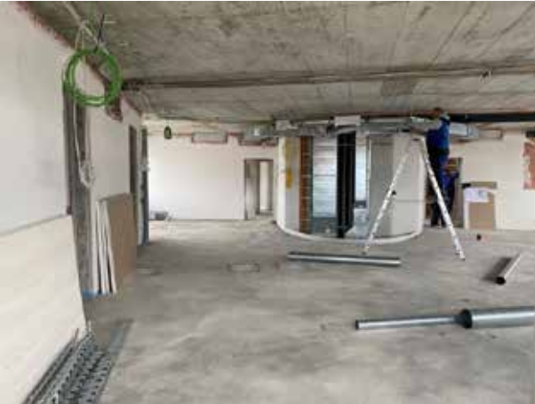
Auch im 2. Stock ist der Estrich verlegt. Die Leitungen für die Heizung/Kühlung laufen an der Decke.
