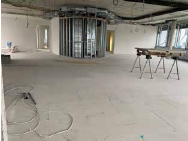
Der Boden ist fertig. Jetzt geht es an das Verkleiden der Lüftungskanäle und Leitungen, die entlang der Treppenhausellipse vom Keller bis ins zweite Stockwerk laufen. Das Ständerwerk ist schon an Ort und Stelle.
