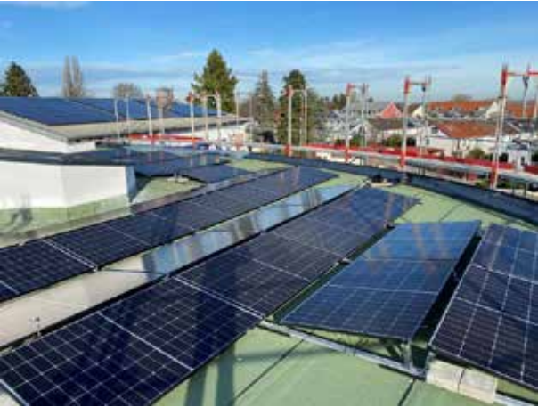
Jetzt sind auf beiden Hausdächern PV-Anlagen. Damit nehmen bei DICTATOR regenerative Energien einen wichtigen Platz ein und tragen ihren Anteil zur Verbesserung der Ökobilanz bei.
