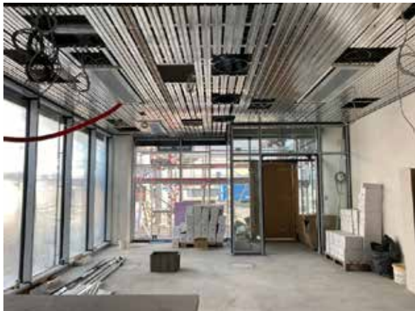
Im Eingangsbereich ist die Heiz-/Kühldecke schon fast soweit fertig, dass die Leitungen darin verlegt werden können.
