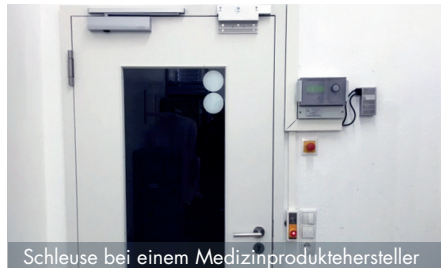
Schleuse bei einem Medizinproduktehersteller
